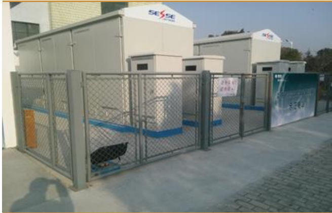
图 28：液流电池储能示范电站
