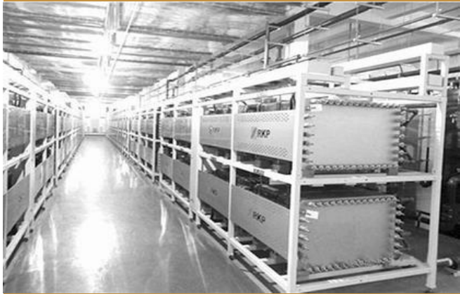
图 26：液流电池储能示范电站
